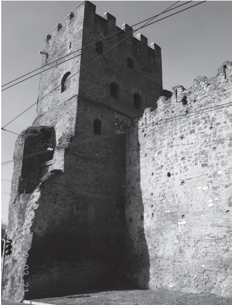
Fig. 9 - Particolare dell'attacco esterno tra il braccio orientale della corte e la torre est in prossimità della porta principale d'ingresso (foto a cura dell'autore).
